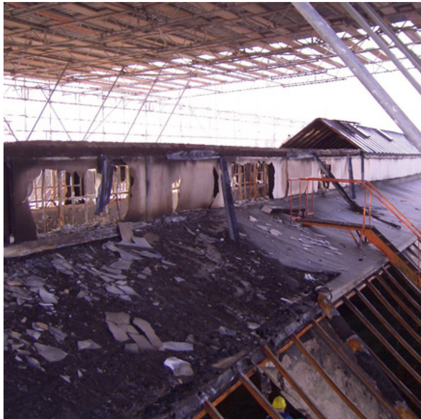
Dach unmittelbar nach dem Brand
